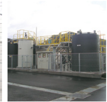
▲定評のある排水処理装置
