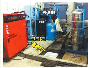
整備場での排水ピットでの油吸着に.....
